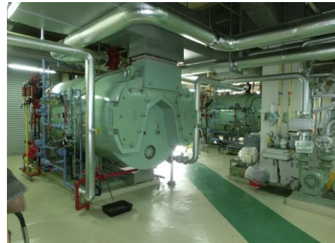
②ボイラー室
