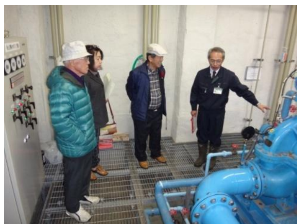
導水陸上ポンプ 2台
