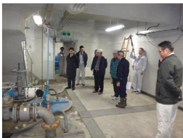
導水水中ポンプ 3台
