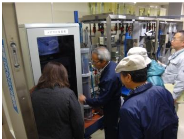
水質自動監視装置（メダカの体育館）
