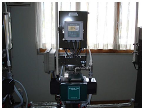
(風連浄水場 配水池濁度計)
