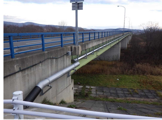
※駐屯地への配水管
