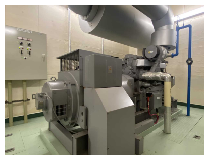
非常用発電設備（緑丘浄水場）
