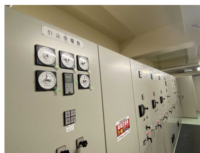
受変電設備（緑丘浄水場）
