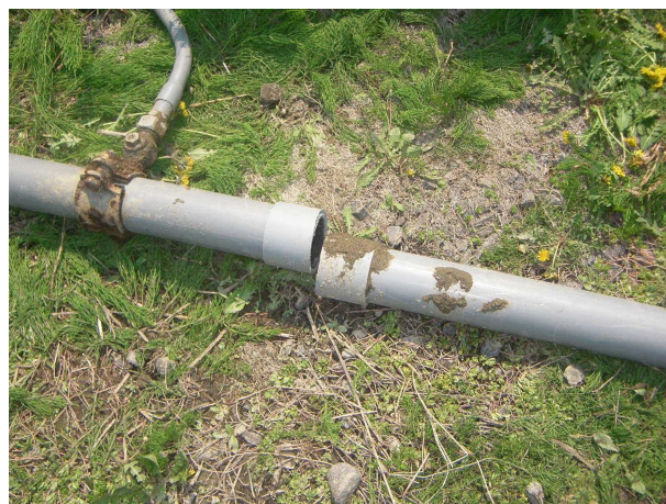
破損状況（老朽化による継手部分破損）
