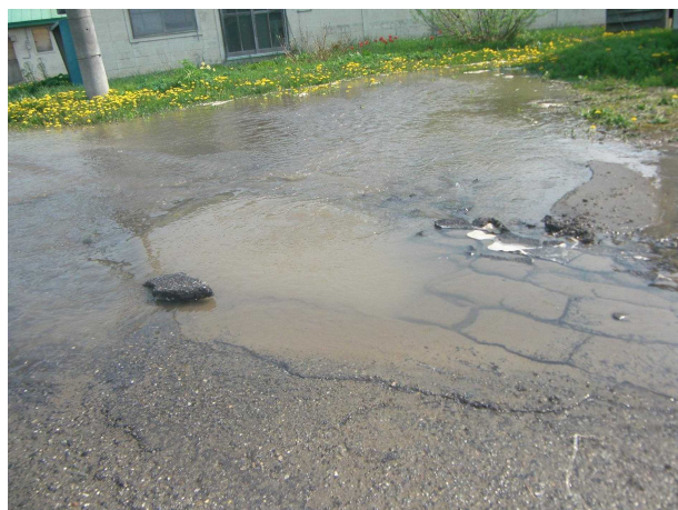
漏水発生状況
