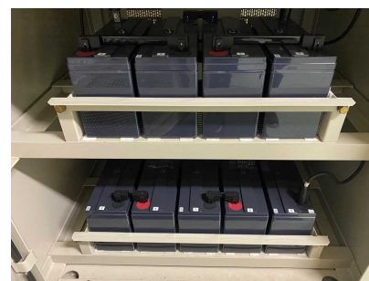
特殊電源設備（緑丘浄水場）
