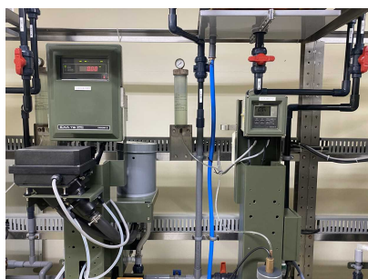
計装設備（緑丘浄水場）
